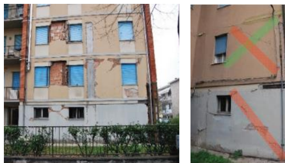
Fig. 4 Danni alle tamponature
